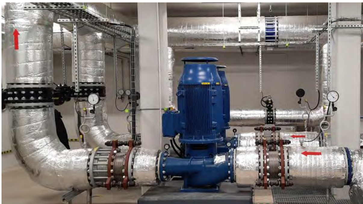
Przepompownia na sieci ciepłowniczej przy ul. Tuwima w Olsztynie (fot. MPEC)
