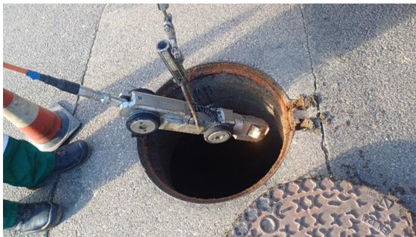
Rys. 9. Przegląd stanu technicznego kanalizacji sanitarnej kamerą TV. Źródło: PWiK Olsztyn
