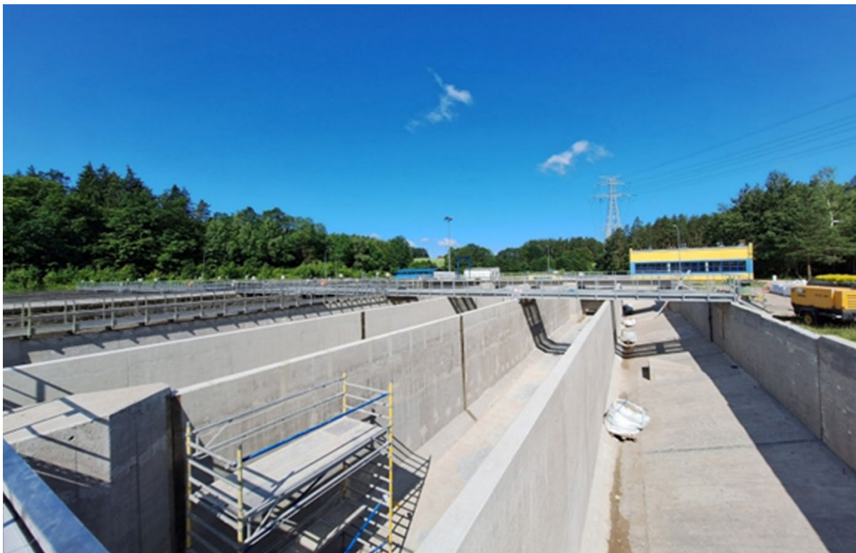
Fot. Modernizacja systemu napowietrzania ścieków w reaktorach biologicznych na terenie Miejskiej Oczyszczalni Ścieków „Łyna” w Olsztynie – roboty konstrukcyjne bioreaktora 18.1 (źródło: PWiK Sp. z o.o.)
