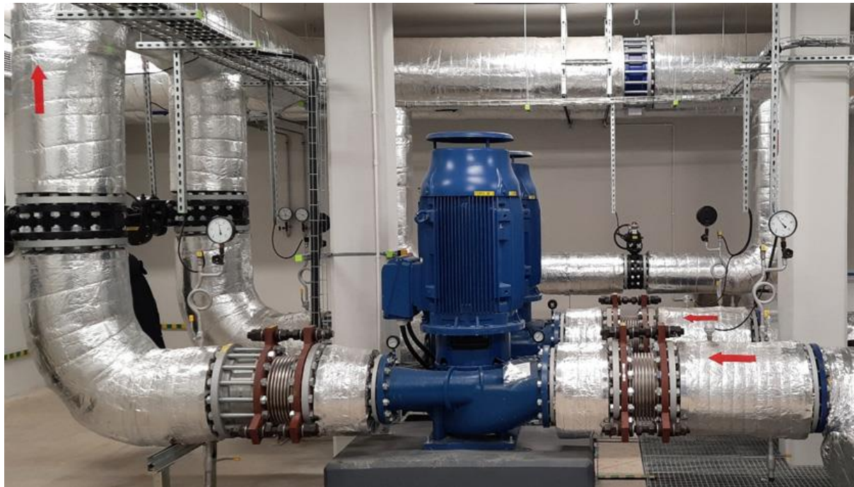
Przepompownia na sieci ciepłowniczej przy ul. Tuwima w Olsztynie (fot. MPEC)
