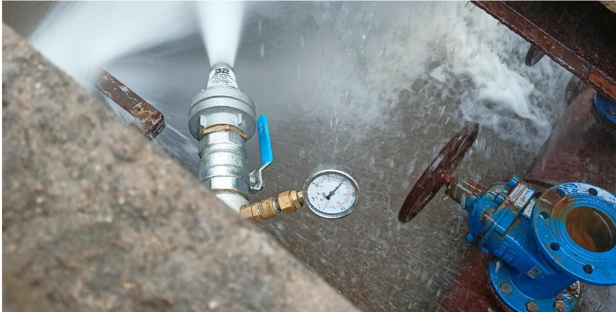
Fot. PWiK Sp. z o.o. Pomiar ciśnienia i wydajności przepływu w komorze przeciwpożarowej przy Pl. Jedności Słowiańskiej
