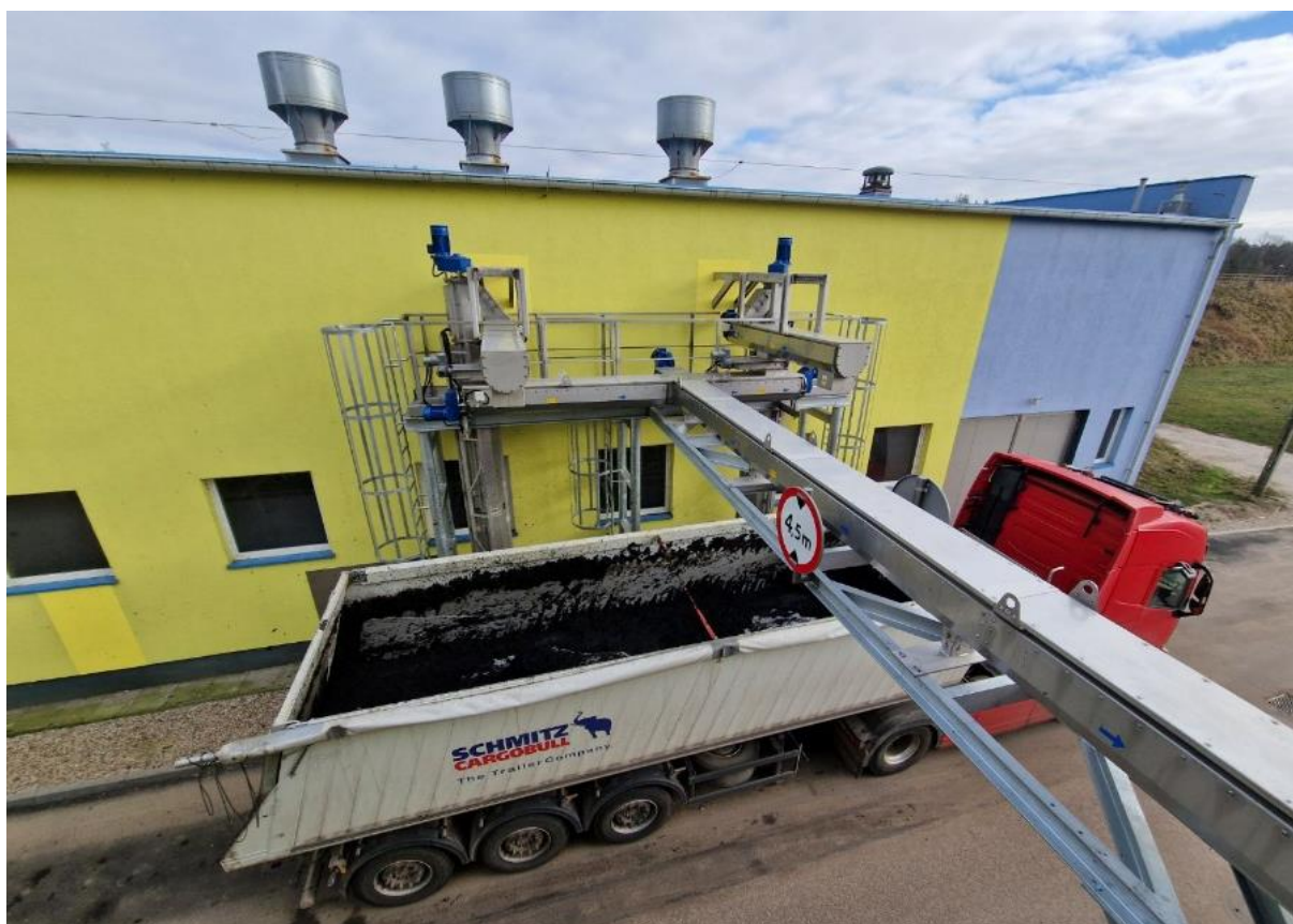
Fot. PWiK Sp. z o.o. Przebudowa przenośników odprowadzających osady z hali pras na kontenery i spalarnię na terenie Miejskiej Oczyszczalni Ścieków „Łyna”
