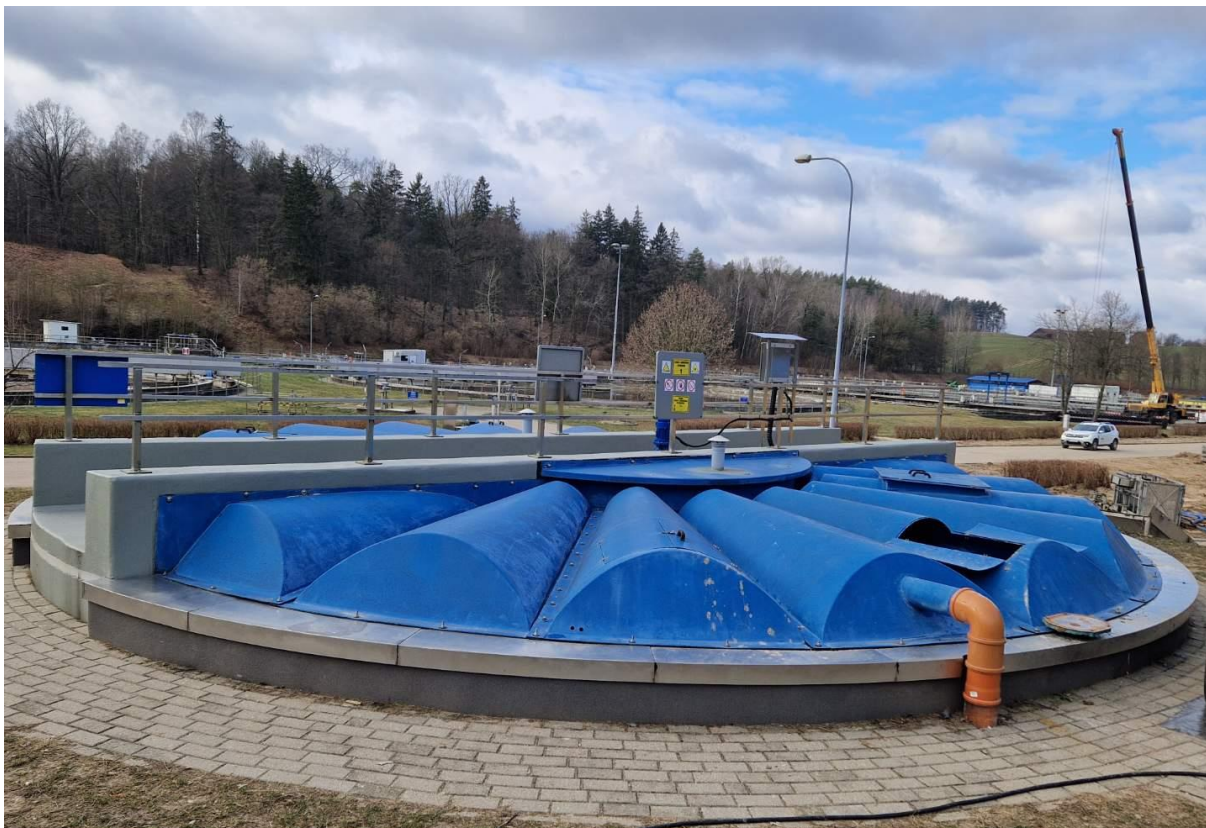
Fot. PWiK Sp. z o.o. Remont zagęszczaczy grawitacyjnych osadu wraz z komorą rozdziatu na terenie Miejskiej Oczyszczalni Ścieków „Łyna”
