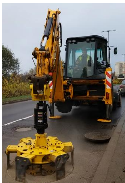
Fot. PWiK Sp. z o.o. Regulacja wjazdów na sieci sanitarnej za pomocą frezu hydraulicznego w ul. Synów Pułku.
